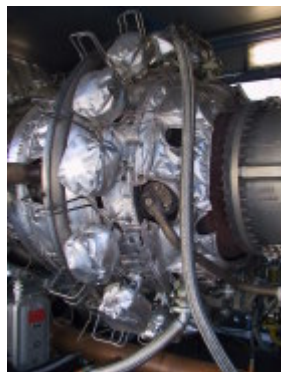
Turbine à gaz, 10.6MW électrique
