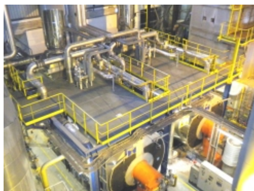
Chaudière 1 et 2, 18MW unitaire
